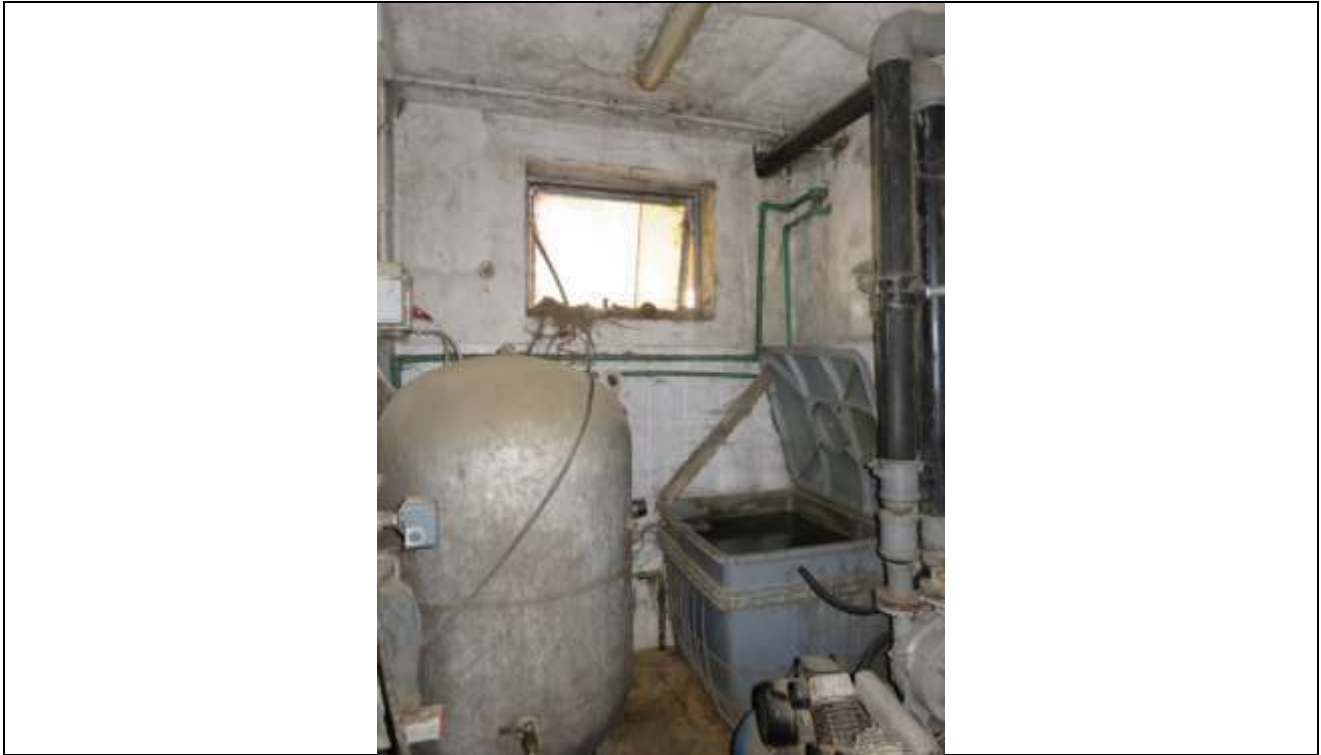
93 Vista di una sala macchine;
