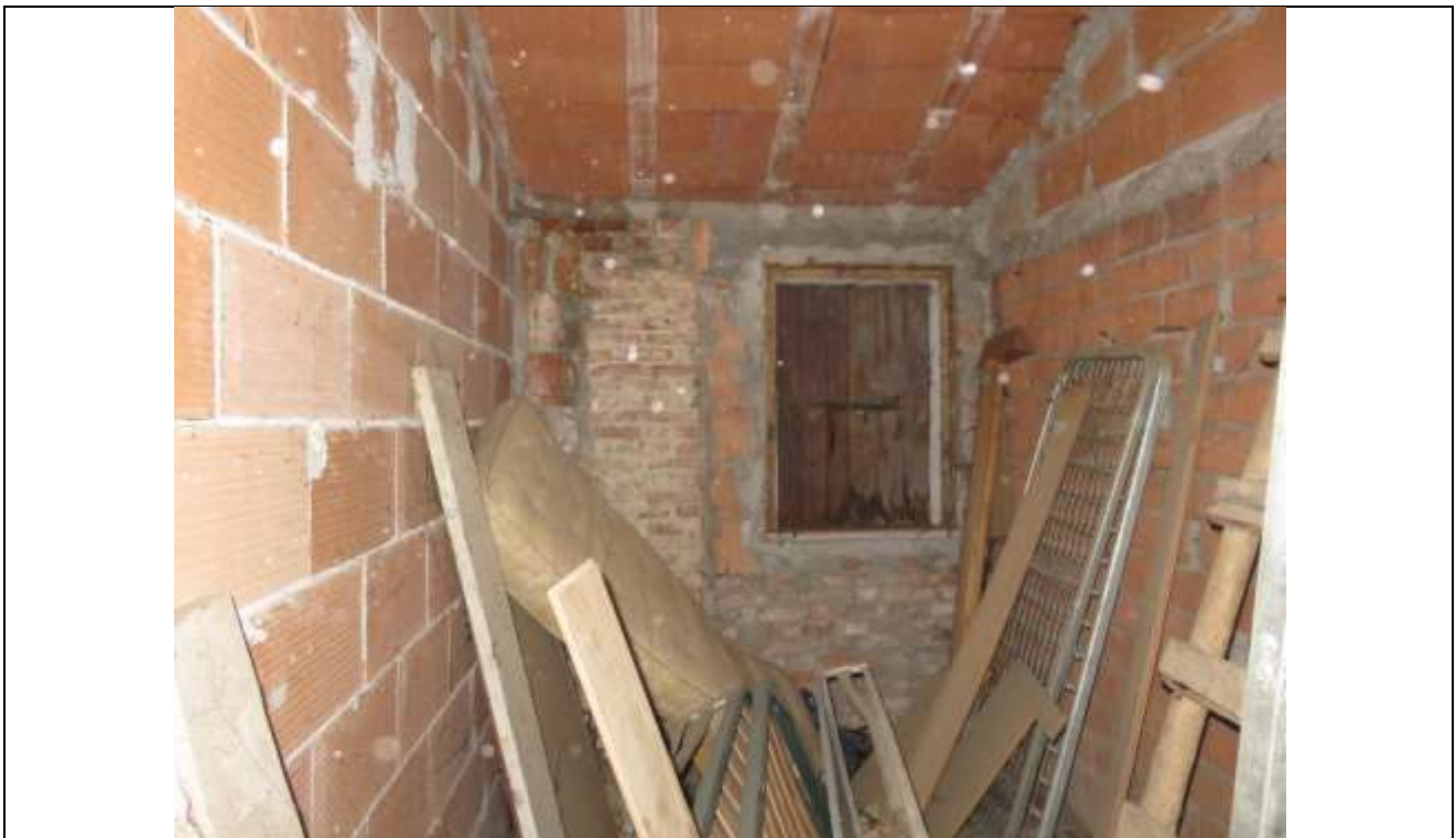
28 Vista del bagno non completato;
