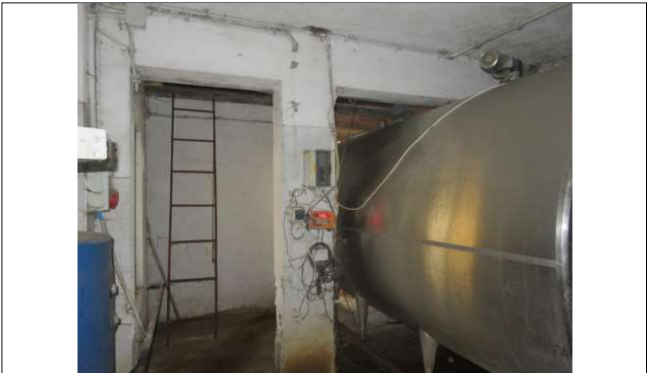
94 Vista della sala macchine ampliata;
