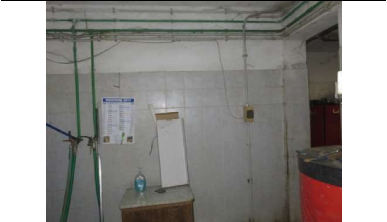
95 Altra vista della sala macchine;
